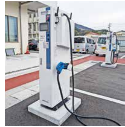
市役所敷地内に設置している急速充電器
