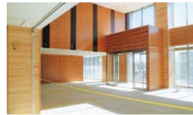
1階待合ロビー内装工事(令和5年1月31日撮影) ※1月末時点の進捗率 工事全体 84.93% 建築主体工事(1工区)98.57%
