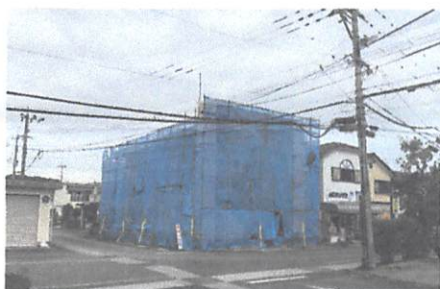
民家に隣接する一部損壊した市施設
