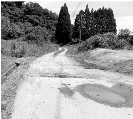
市道川向東光寺線の未舗装箇所
