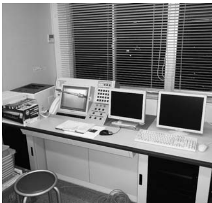
移設予定の防災無線機器
