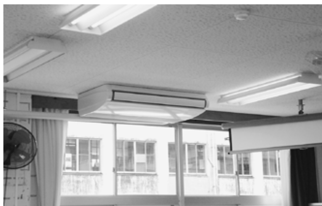
整備された空調機器(吾田中学校)
