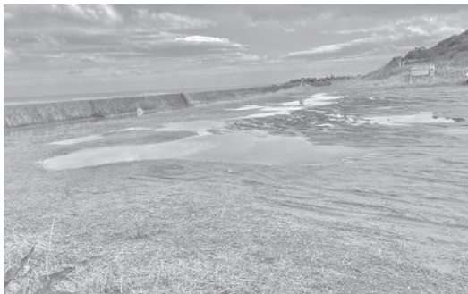
降雨後の風田浜の駐車スペース
