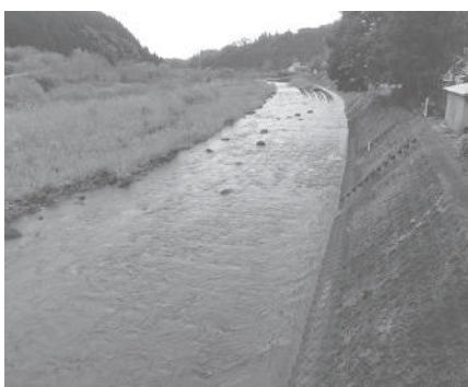
豪雨時、堤防越水に数十センチまで増水する酒谷川の箇所
