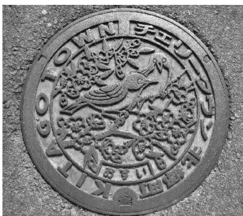
公共下水道のマンホール
