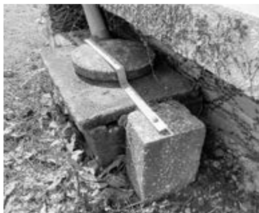
改修を必要とする公園トイレ
