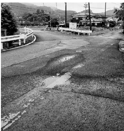
劣化しているグリーンベルト
