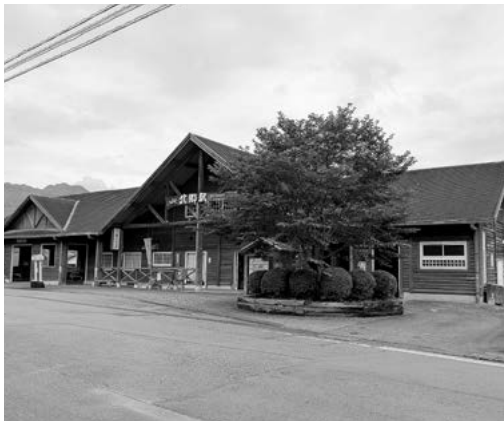
シロアリ被害を受けている北郷駅舎
