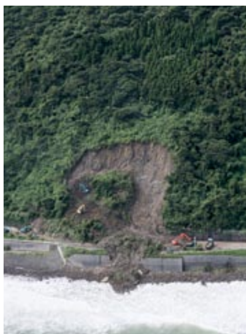
台風による道路の寸断 (H20.9.18被災)
