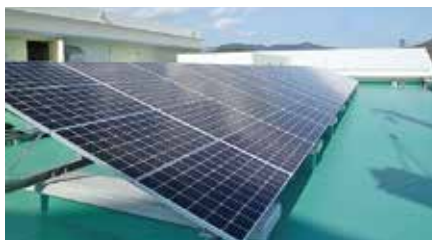
屋上階の太陽光パネル
