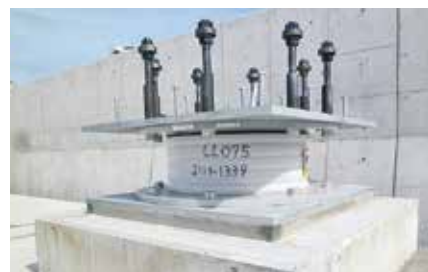
実際に設置した免震装置
