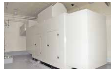
大規模災害発生時に72時間分の電力をまかなう発電機
